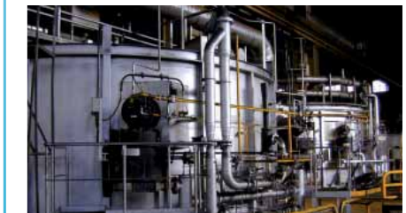
Four à sole tournante équipé de brûleurs régénératifs destinés au travail des métaux dans l'entreprise Aubert & Duval (09)
