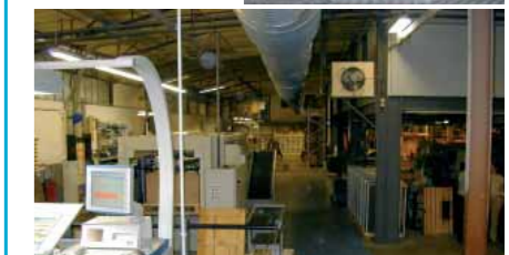
Rafraîchisseurs d'air intérieur à évaporation directe dans l'atelier de production des Cartonages d'Auch (32)
