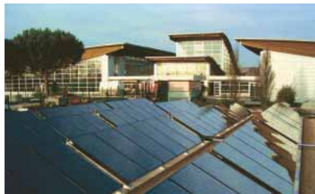
Complexe piscine-patinoire de l'Archipel à Castres (81) Installation solaire collective destinée au préchauffage de l'eau des sanitaires et des bassins intérieurs réalisée grâce au soutien du PRELUDE - Source: Claudia Zerrate - Communauté d'agglomération de Castres-Mazamet
