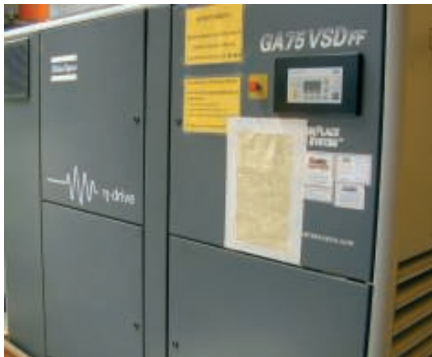
Compresseur d'air comprimé à vitesse variable
