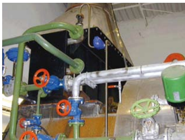
En noir, l'économiseur installé en sortie de chaudière.
