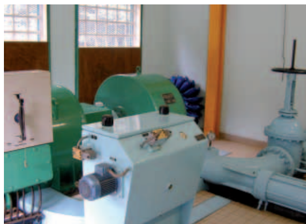
Centrale hydroélectrique du Mas Naffre : équipements intérieurs
