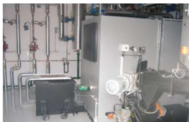
Chaudière au bois.
