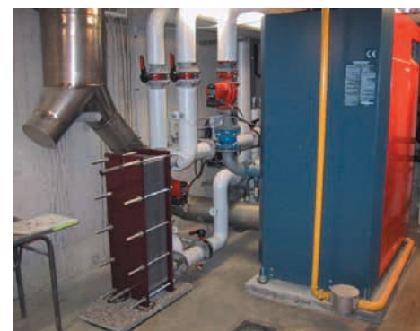
Vue d'un échangeur placé sur le réseau de chaleur.
