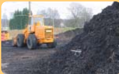
Plate-forme de compostage de déchets verts
